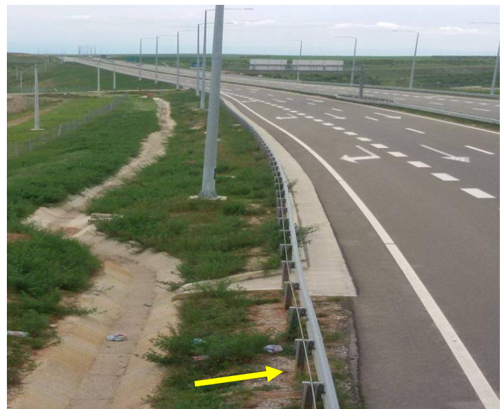
Fig. 14. Barriera rrugore shtylla për ngritje W6, në segmentin e autostradës “Ibrahim Rugova”.
